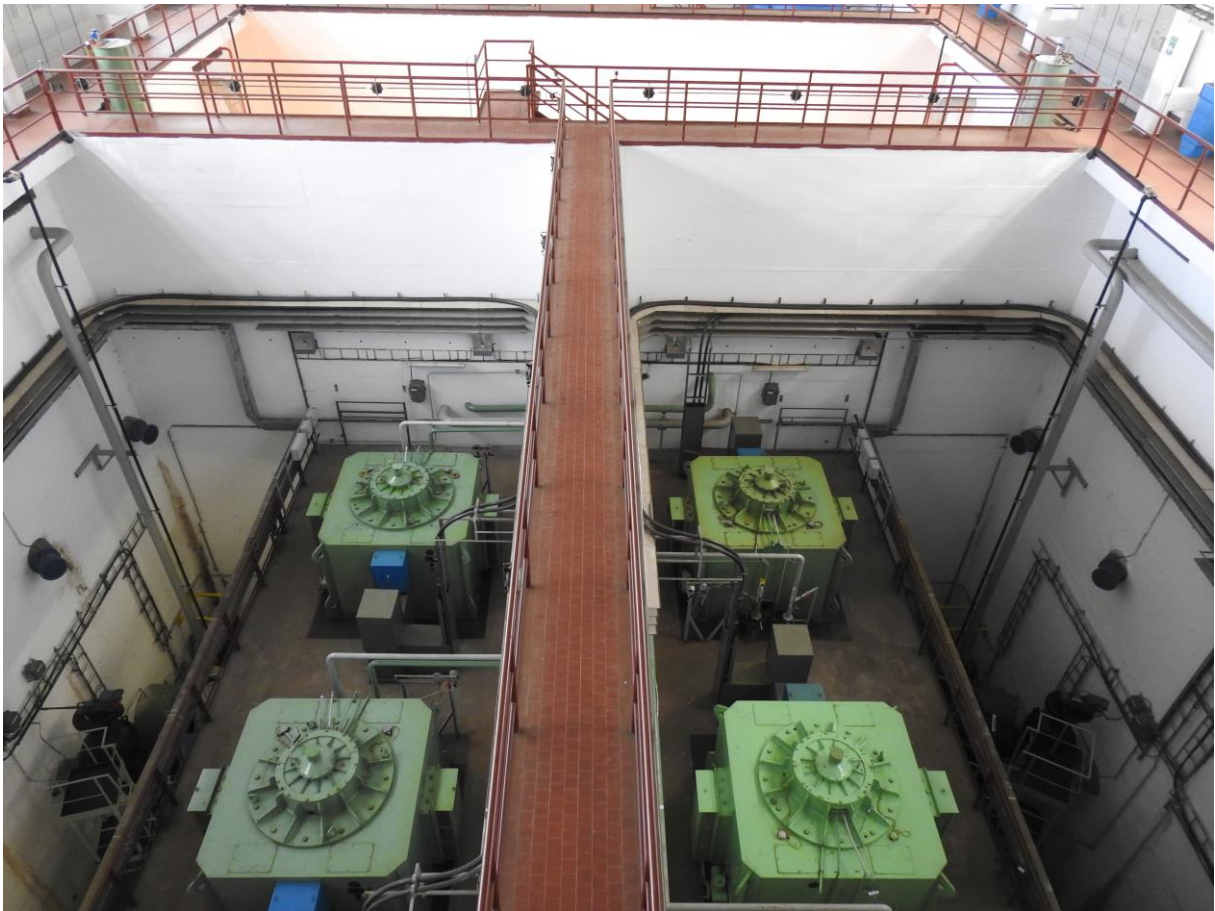
Obrázek 4: Strojovna ČSH – sekce čerpadel
